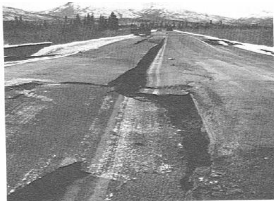
عکس شماره ۱: تخریب مسیر به علت تأثیر زلزله
